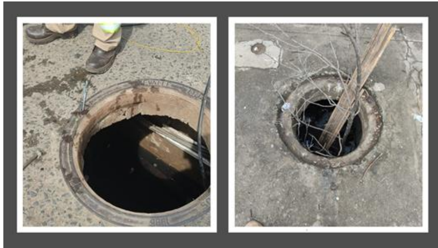
Figura 51 Evidencia del robo de las tapas de las cámaras de acueducto y alcantarillado.
