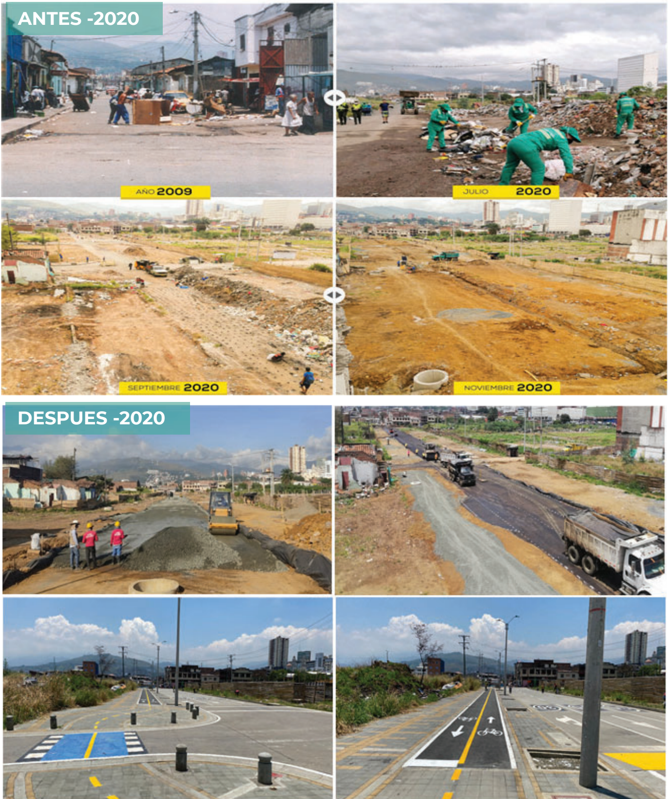
Figura 105: Fotos, Biblioteca digital Empresa de Desarrollo y Renovación Urbana EDRU / Ampliación Vial carrera 12 y calle 13 / Presentación Cali ciudad sostenible 2023
