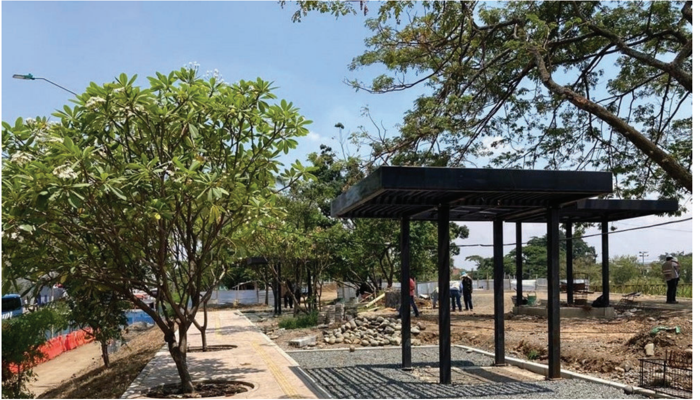
Figura 133: Foto, Biblioteca digital Empresa de Desarrollo y Renovación Urbana EDRU /Parque Pacífico avance de obra dic 2023
